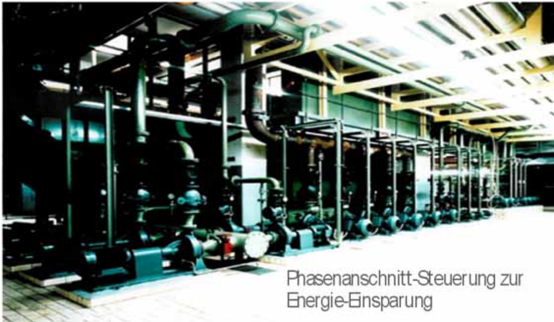
Bild: Pumpstationen bei der KSS-Zentralversorgung im Mercedes-Benz Werk Stuttgart
