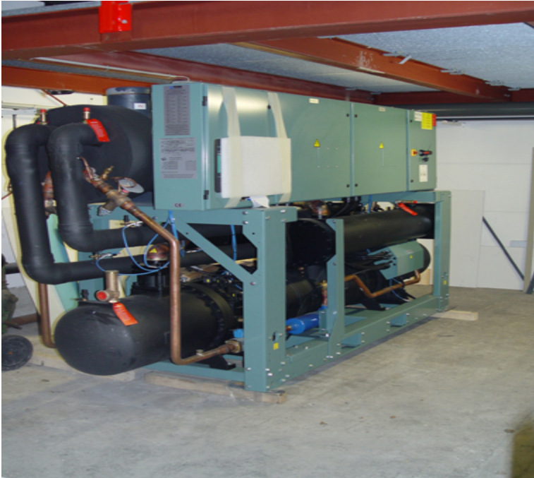
Foto: Moderne Kältemaschine
