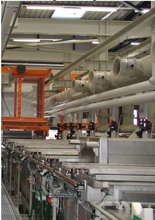
Bild: Abluftanlage in einem galvanotechnischen Betrieb
